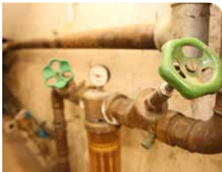
Mit Ventilen wird der Wasserzulauf gestoppt.
