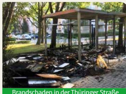
Brandschaden in der Thüringer Straße
