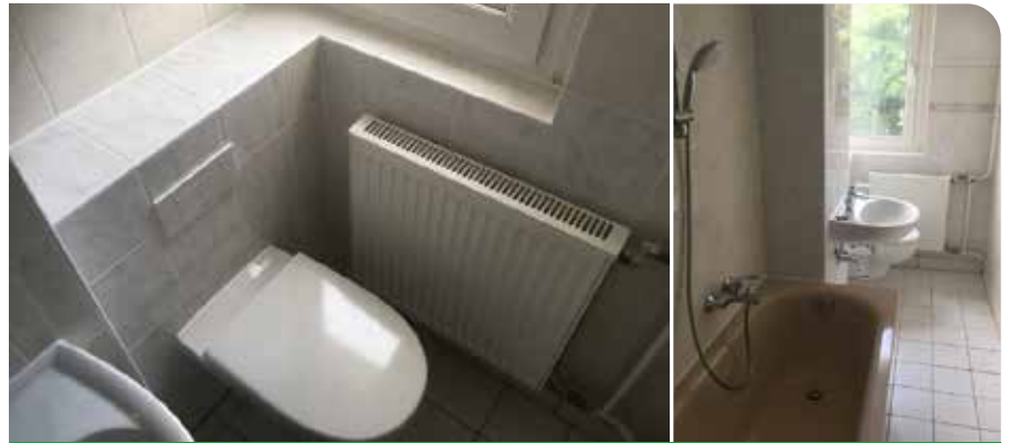
Die Versorgungsstränge mit Strom, Wärme und Wasser müssen in einigen Wohnhäusern erneuert werden – so auch in der Saarlandstraße 11-25.
